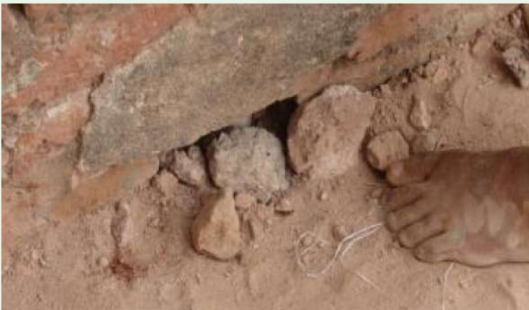
سوراخ هایی در سیستم ضد آب سقف یک پاگودا در باگان، میانمار، ۲۰۱۶. تصویر نیوجینی کریتی
