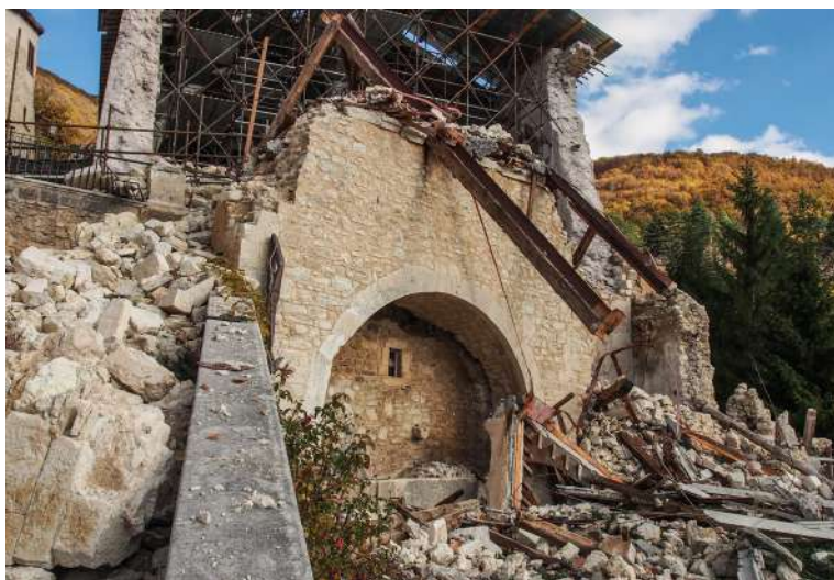
イタリア、地震の被害を受けた非フレーム型の構造。2017年。写真: エイスケ・ニシカワ
