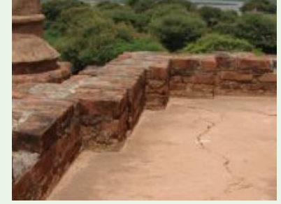
Tapınağın damındaki çatlaklar, Bagan, Myanmar, 2016. Foto: Eugénie Crété.
