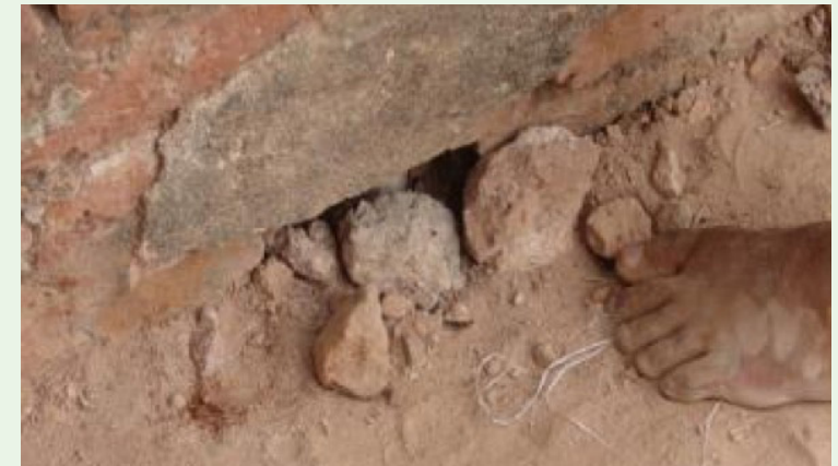
Bir pagoda'nın damındaki su giderindeki çatlaklar, Bagan, Myanmar, 2016. Foto: Eugénie Crété.
