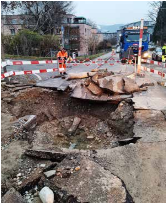
Bruch der Transportleitung in der Badstrasse.
