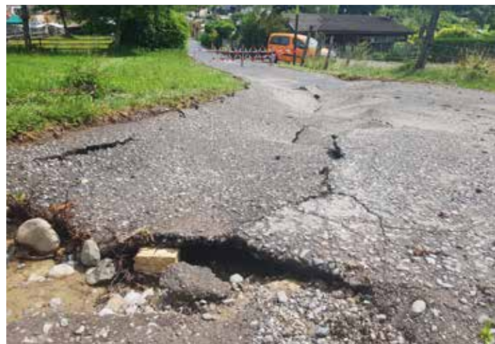
Schäden beim Familiengartenweg durch Hochwasser.
